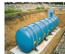
【耐震性貯水槽】
